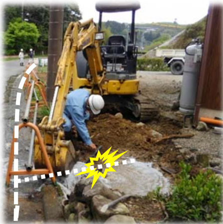
水道管を損傷
