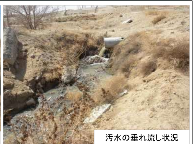
素掘りの下水処理施設
