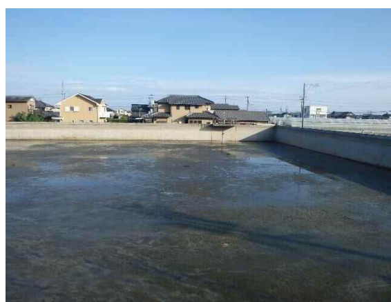
西山調整池の底に溜まった泥の状況
