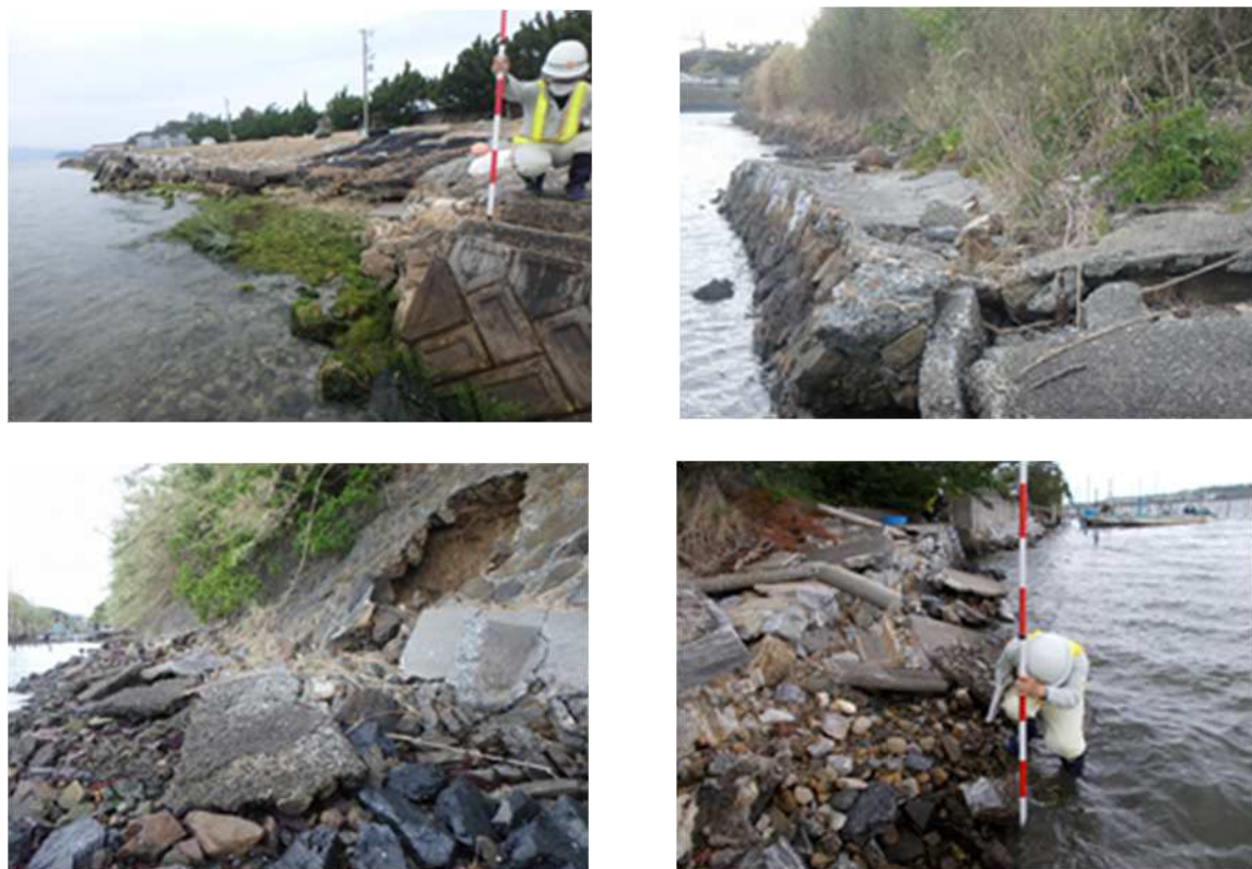
図 3.4 老朽化した湖岸堤
