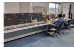
寺谷浄水場 中央監視室
