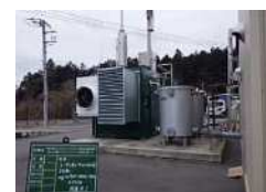
バイオマスプラント発電機
