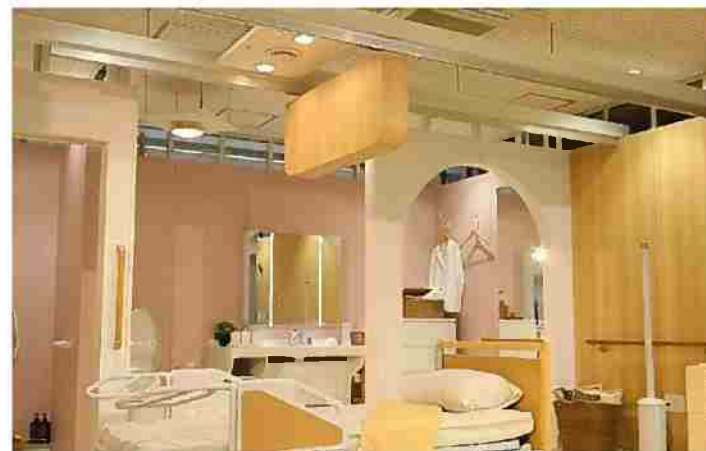
天井走行ヘルスサポートシステム&ツールボックス
