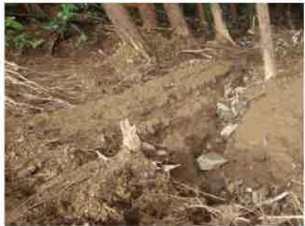
排水施設の不良により生じた盛土の侵食
