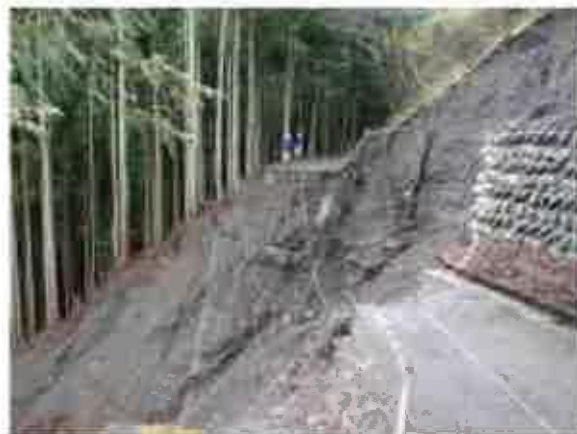
林道羽ヶ島線の被災状況（島田市家山）
