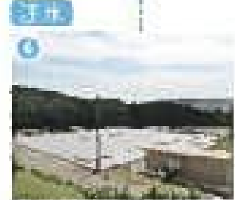
東海電力 (http://www.tokai-epc.com/) 海拔30mの高台に 緊急時放水ポンプを設置
