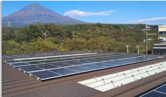
太陽光発電パネル（工場の屋根置き）
