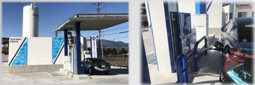
水素ステーション（御殿場）
