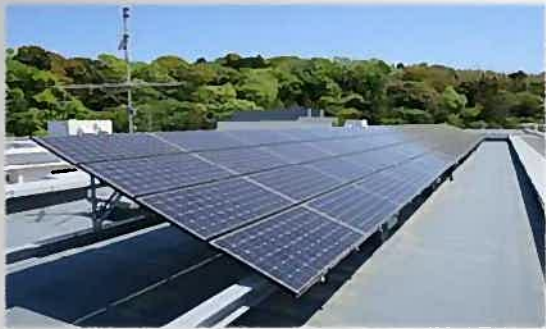
太陽光発電パネル（屋根置き）
