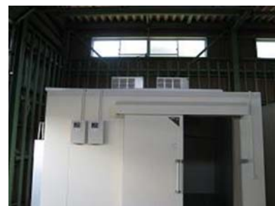
恒温高湿冷蔵庫の整備
