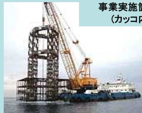
鋼製魚礁沈設の様子 (大型起重機船で近隣の製作場所から運搬し、所定の場所に沈設)
