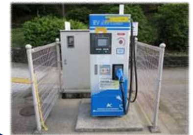
県庁のEV用急速充電器
