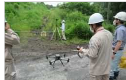
危険性のある盛土の現地確認の様子
