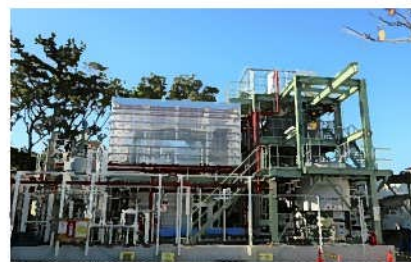
水熱炭化設備の外観
