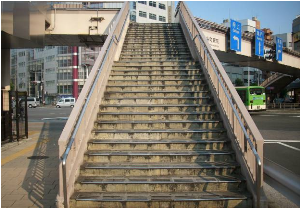
歩道橋階段蹴上(未塗装/6年経過)
