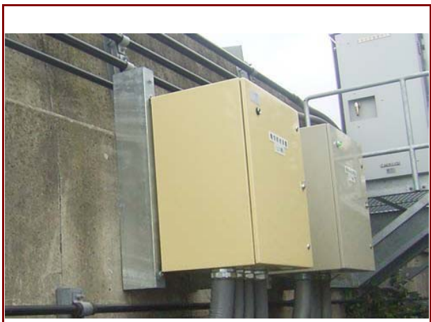
直流電源装置設置状況
