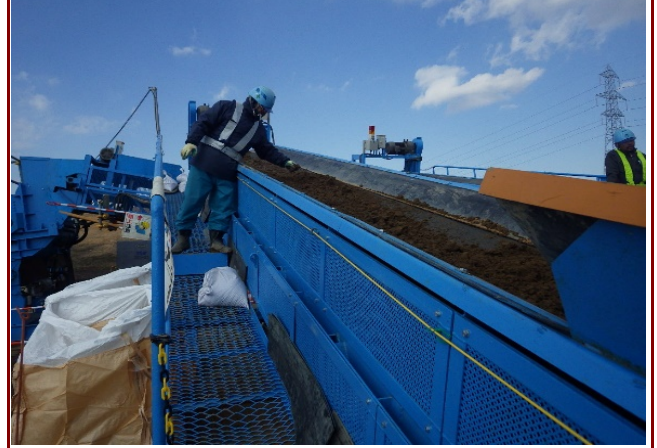
計量コンベア(混合用土の計量・搬送)
