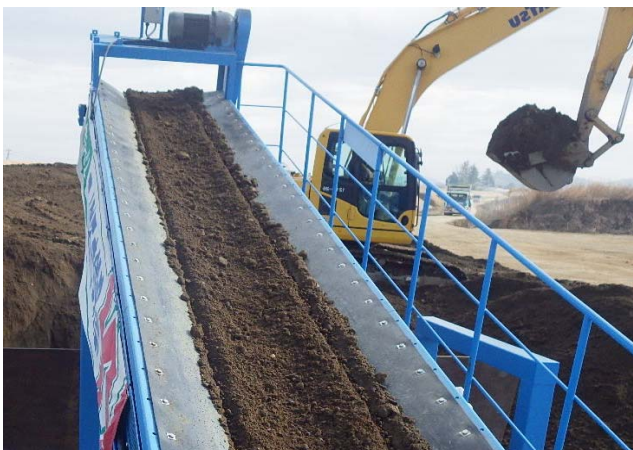
排出コンベア(混合処理土の搬送)
