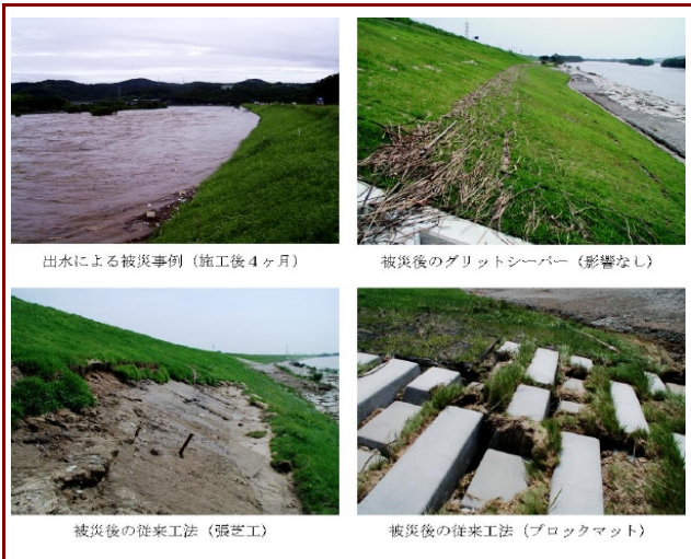
被災事例写真(岡山県内の河川)
