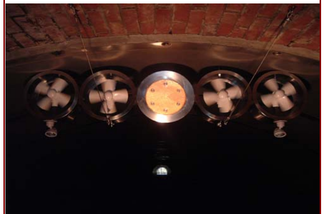
設置実績写真(三ヶ日本坂線本坂隧道) ※オプション付き(スポットLEDライト)
