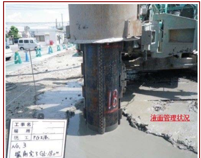
液面管理状況
