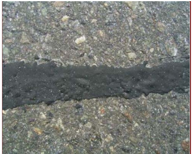
クラックシールNX 3年供用後
