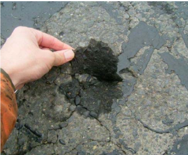
従来品 破損事例(剥がれ)
