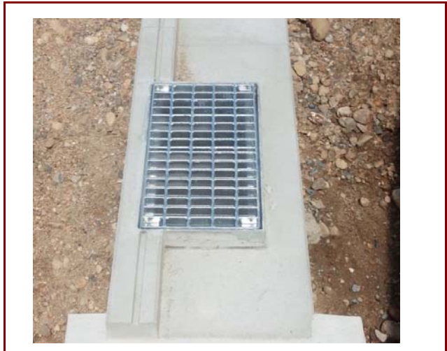
管理部設置状況
