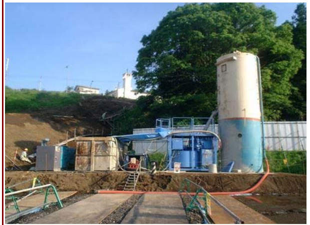
固化材スラリープラント
