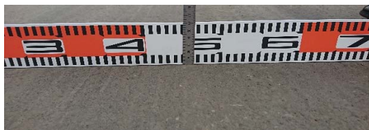
ニュートラック わだち掘れ量: 1mm
