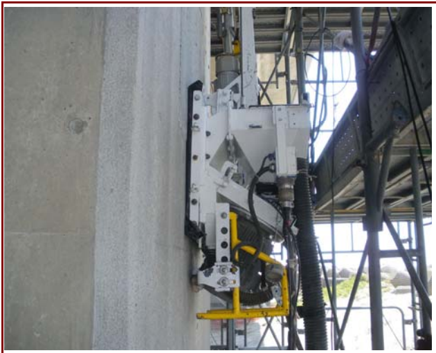
研掃ロボ稼働状況
