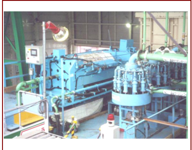
濃縮泥水システム
