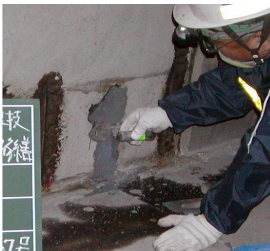
マクサムサンドイッチ(断面修復)工法樹脂モルタル塗り写真
