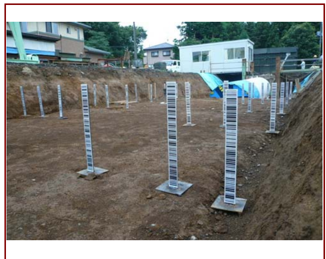
宅地の地盤沈下の監視
