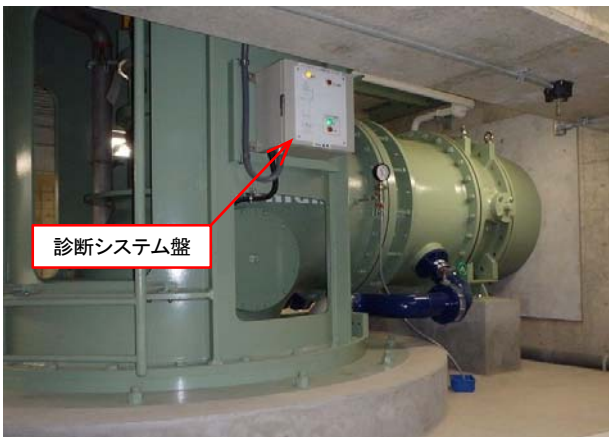
診断システム盤設置状況
