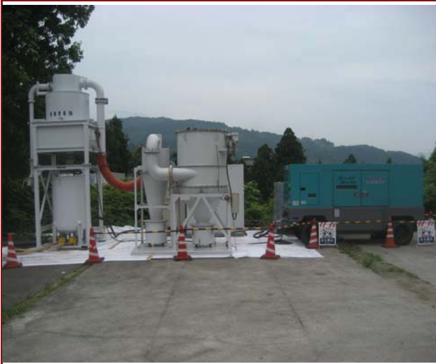
プラント設備
