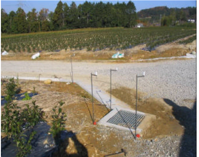
リフレクター設置状況
