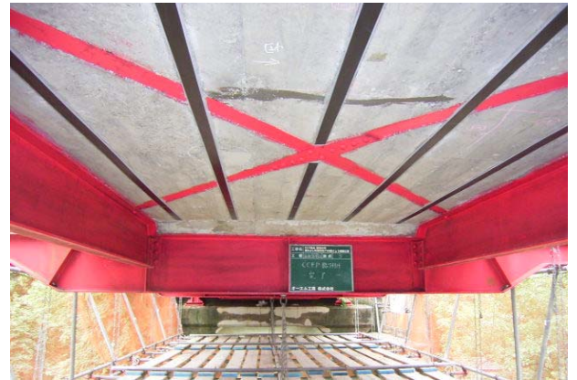
H17昼間辻線ノ東みよし町昼間他P93橋りょう修繕工事(美濃田大橋)
