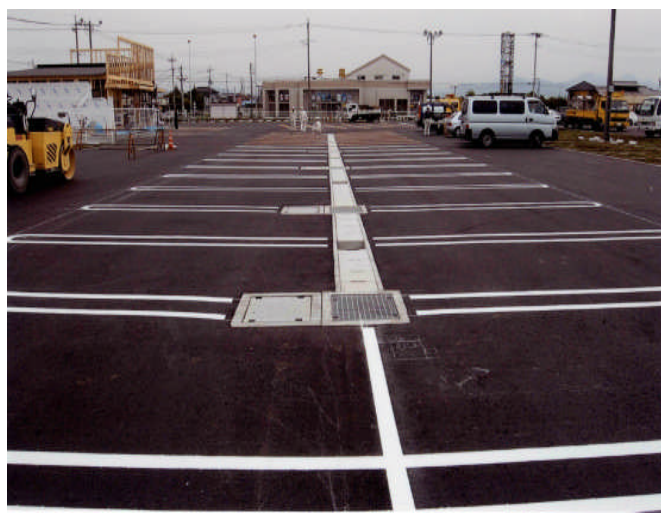
開発に伴う民間施設 (駐車場下部に設けた雨水流出抑制施設の完成状況)
