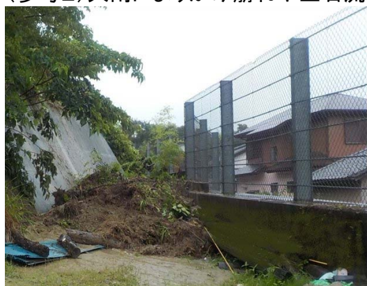
擁壁が住宅への土砂流入をストップ！ 「萱間谷田ノ谷」(袋井市萱間) 災害発生日:7月3日
