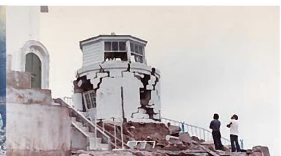
大破した石廊崎灯台
