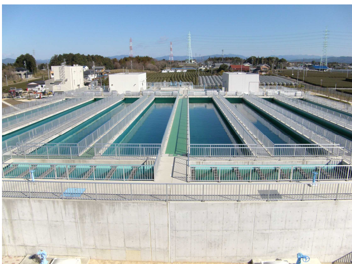
遠州水道 寺谷浄水場
